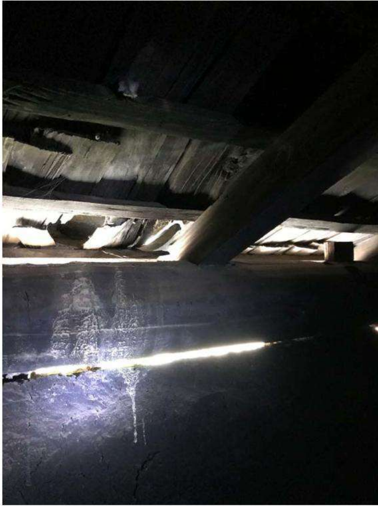
小屋裏；雨漏れ跡
