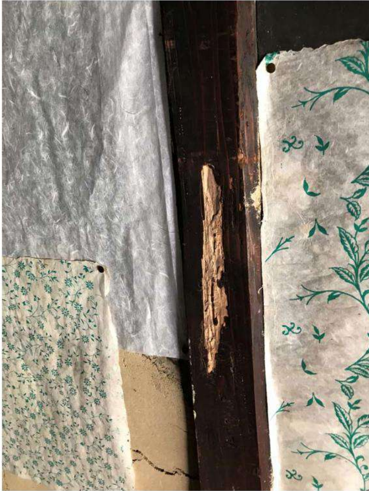
オモテ南面柱：蟻害跡
