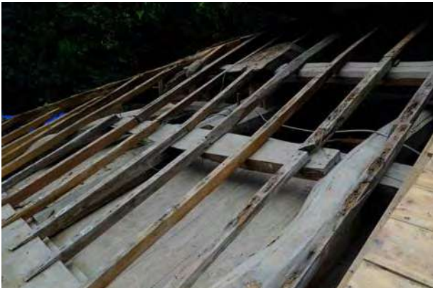
▲破損した垂木 舞台正面（北面）
