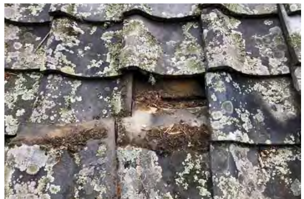
▲棧瓦の葺き土 葺き土が流出している
