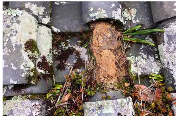
▲本瓦の葺き土 粘土が流出し湿潤状態にある
