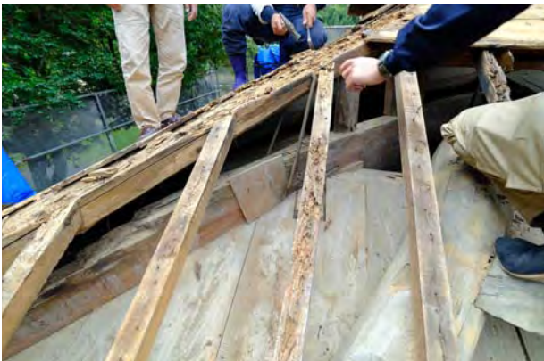
▲舞台下手野隅木 折損の状態
