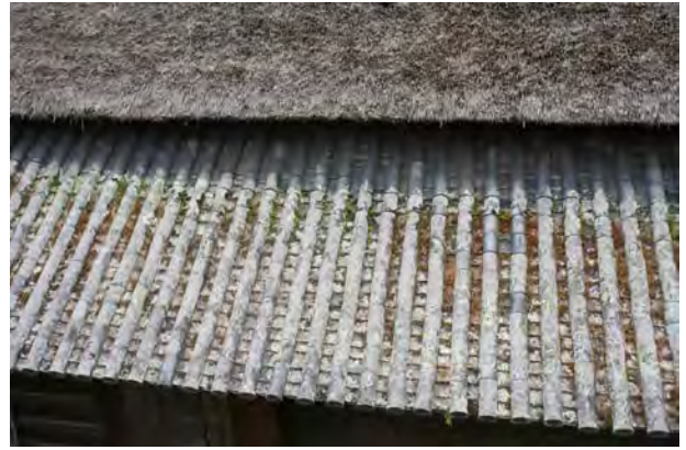
▲舞台正面の本瓦葺屋根 全体に劣化が進行している
