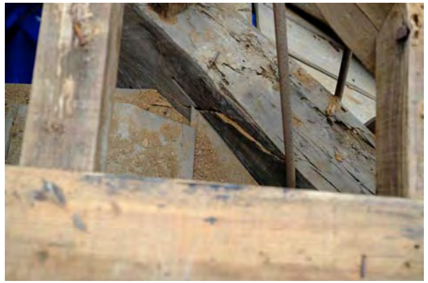
▲舞台下手野隅木 折損の状態
