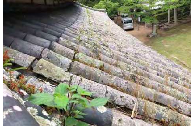
▲舞台正面の本瓦葺屋根 全体に瓦のズレが確認できる
