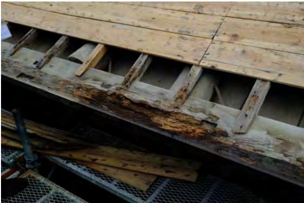
▲破損した裏甲 舞台正面（北面）
