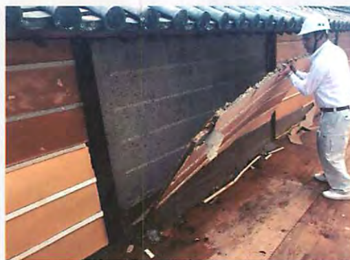
修理壁の下層から旧定規筋の痕跡を発見
